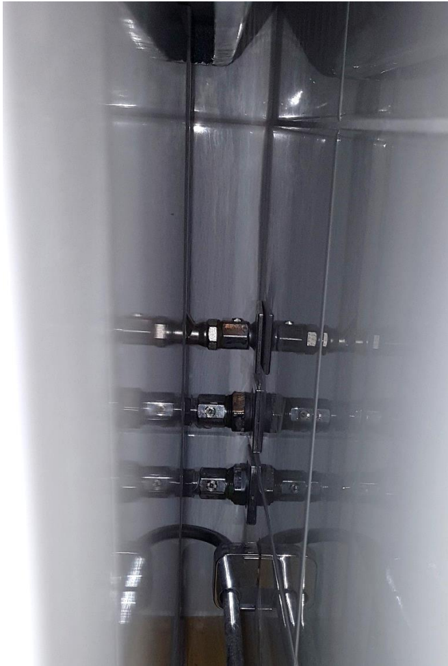
Rör genomföringar genom vägg i våt zon. Ballofixventiler.
