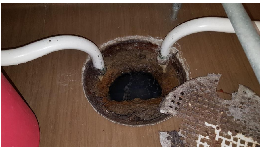
Rostig brunn av gjutjärn i tvättstuga
