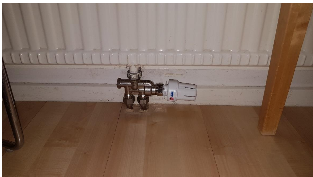
Ett-rörssystem med ny ventil och termostat
