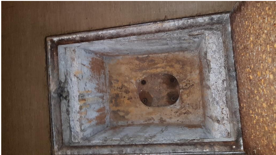
Rensanordning i bottenbjälklag
