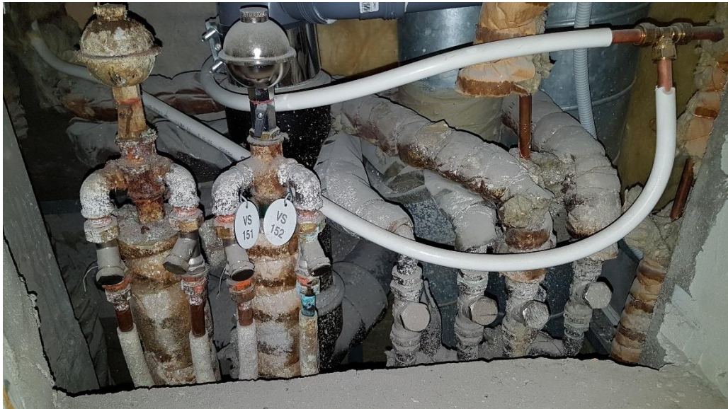
Rörschakt i trapphus med tappvatten, värme, avlopp och dagvatten, öppet mellan våningarna
