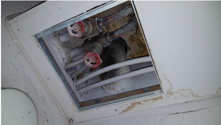
Övergång från stående till liggande ledning av gjutjärn
