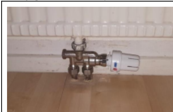
Ettrörssystem med ny ventil och termostat
